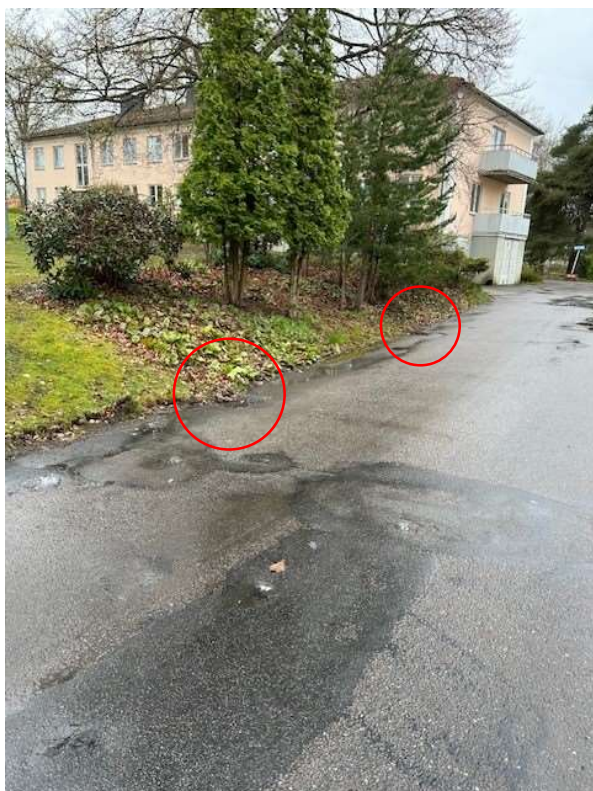
Figur 11. Lågpunkt, brunnar markerade och ingen ansamling av vatten syntes
