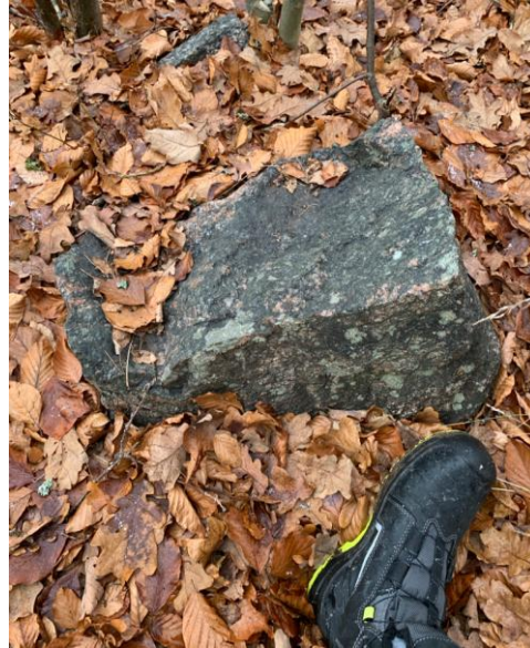
Figur 10. Kantigt block nedanför bergslänt.
