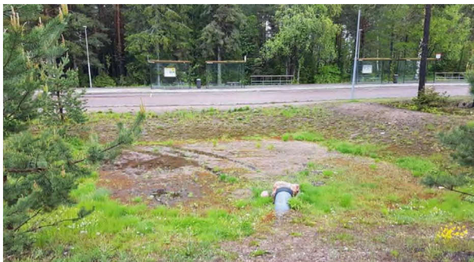
Figur 7: Exempel på hur en utformning av torrdamm kan se ut i praktiken.
