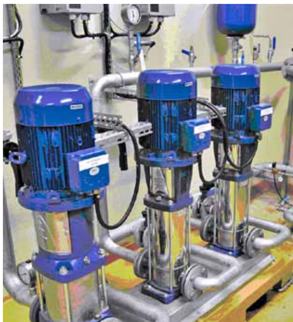
Renoveringen av Igelfors vattenverk innebär att kommunen har fått sitt första kemikaliefria vattenverk där UV-ljus har tagit över klorets roll.
