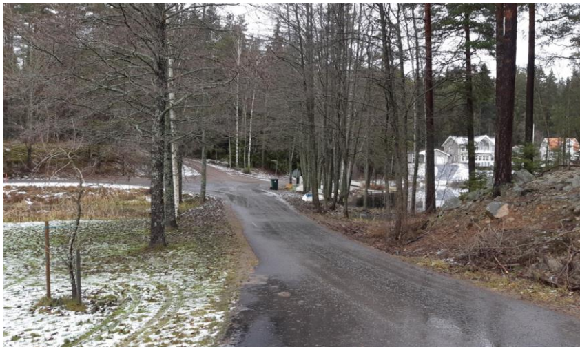
Figur 9. Porsvägen strax innan Kvarnsjövägen. På västra sidan vägen är en damm belägen, på östra sidan står vattnet i Käringfisket nära vägnivån i ett vägparti, för lokalisering på karta se figur 5.
